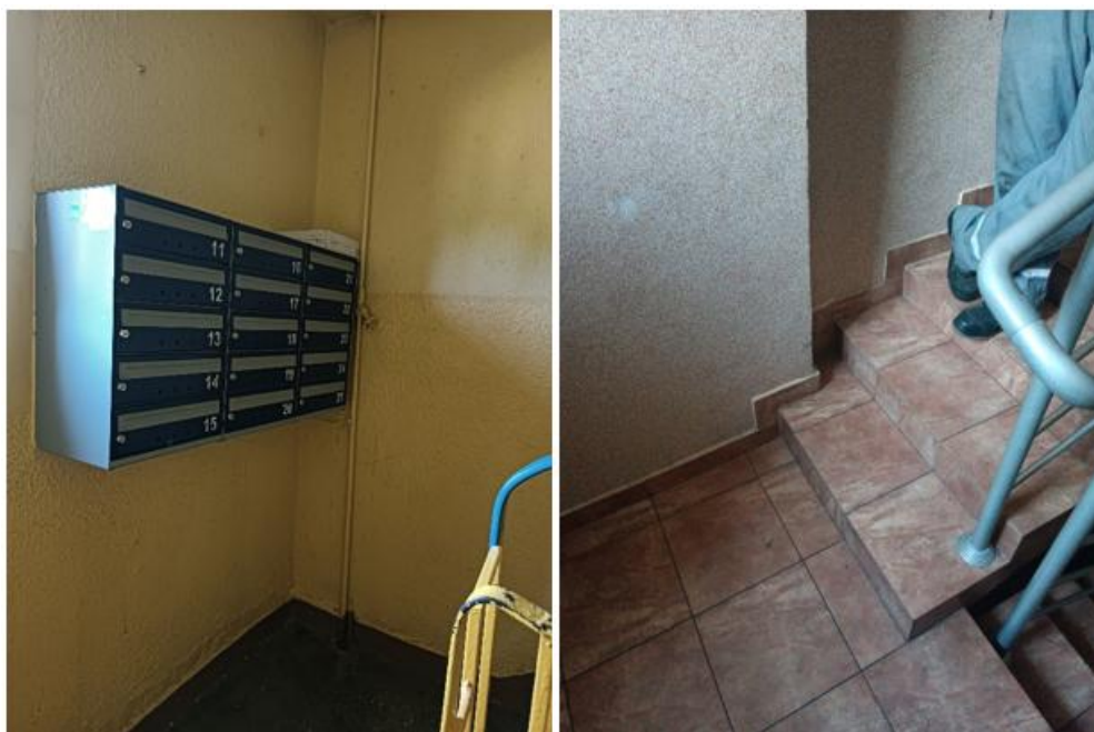
Zdjęcie 13. Zawężenie szerokości dróg ewakuacyjnych
