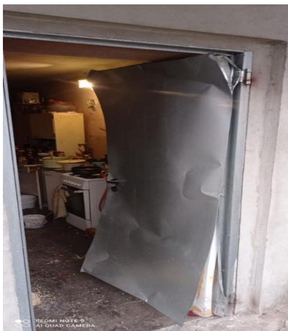
Zdjęcie 41. Wybuch gazu w budynku gospodarczym – Karasica 3
